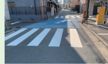
網屋立筋 交差点の改修 経年劣化した交差点を改修し、交通安全対策をしました。
