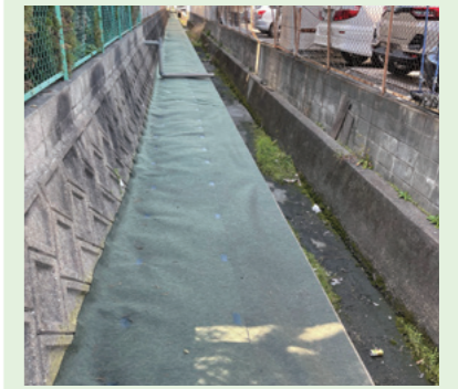
松島校区 用水路の草刈りと防草シート施工 地域の方が定期的に草刈りをして頂いていた所を防草シート施工により草が生えないようになりました。
